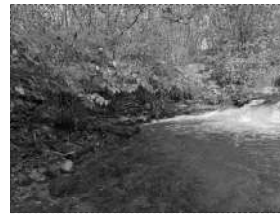
Dissesto spondale con accumulo di detriti in valle della sponda (in sponda dx)
