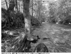
Alberatura in alveo in sponda dx con rami parzialmente eccesi
