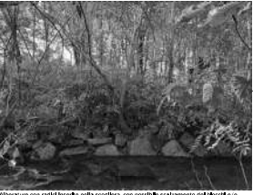
Alberatura con radici dissestate nella scogliera, con possibile scagliamenti del blocco o crollo di roccia in sponda dx
